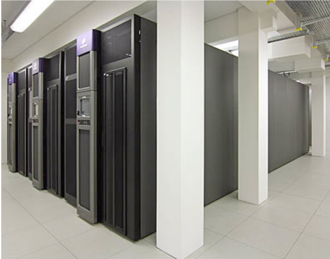
Abbildung 10: Ein Teil dieses High Performance Storage Systems am Deutschen Klimarechenzentrum wird für das WDCC verwendet. Das Bild zeigt drei der sechs vorhandenen Bibliotheken mit je 10000 Ablageplätzen für Bandkassetten. Jede Bandkassette hat zur Zeit eine Kapazität von einem Terabyte.
